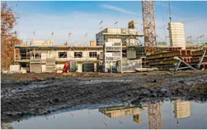
Leichte Verzögerungen, die sich aber wohl aufholen lassen: Das zukünftige Haus des Sports an der Berliner Straße
